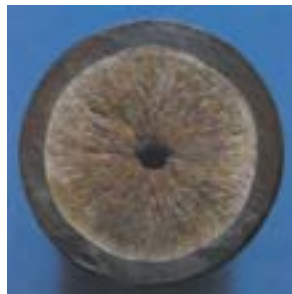
Tubo galvanizado obstruido
