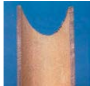
Tubo galvanizado con corrosión
