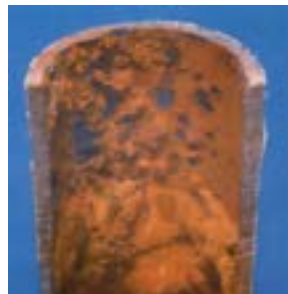
Tubo galvanizado con corrosión
